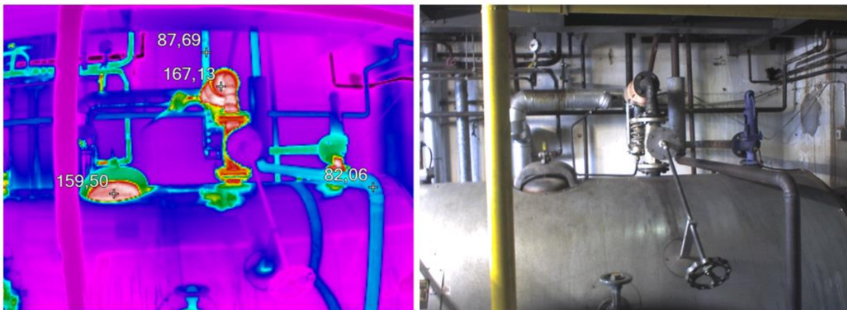
Abbildung 31: Dampfkessel mit nicht isoliertem Mannloch und Anbauteilen
